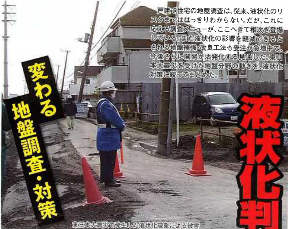
東日本大震災で発生した液状化現象による被害
